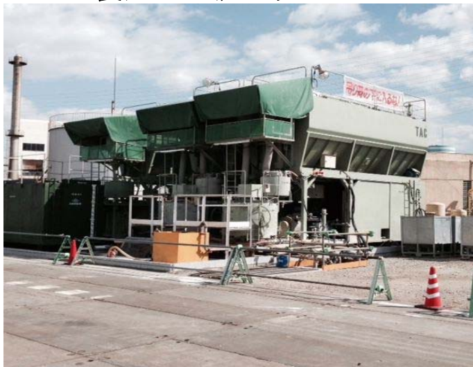
裏込め加泥プラント
