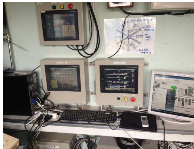
裏込め・加泥・気泡操作盤
