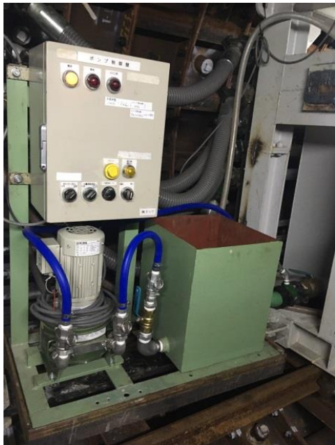
同時裏込め注入管洗浄水用の消泡材自動作液ユニット
