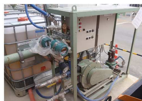
二次処理剤自動添加装置
