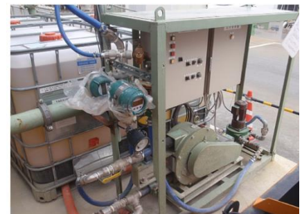
二次処理剤自動添加装置
