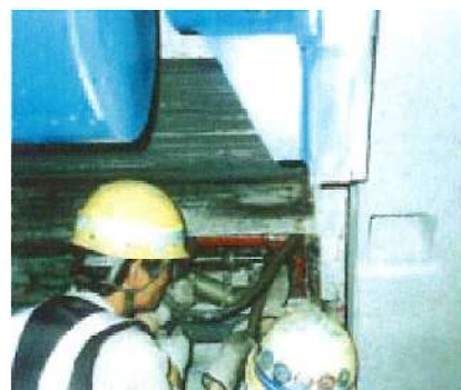
流入管取り出し
