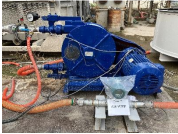
A 液圧送ポンプ
